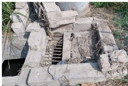
Figura 4. Caja 2 de entrada y de salida de agua dentro del PIPS de maíz
