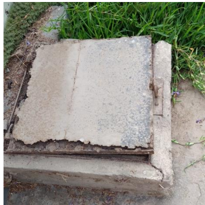
Figura 6. Caja de entrada y salida de agua cerrada - SUTUNA
