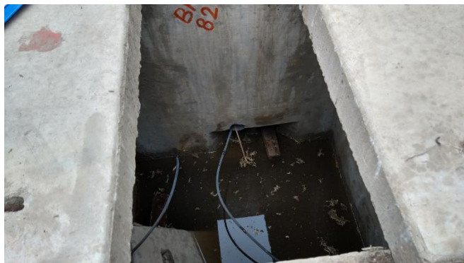
Figura 5. Caja de entrada y salida de agua, cerca de Cuna Infantil
