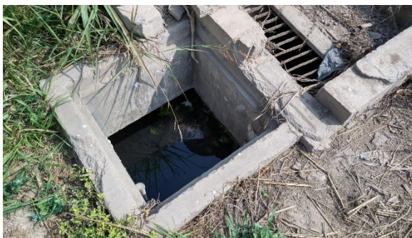
Figura 3. Caja 1 de entrada y salida de agua dentro del PIPS de maíz
